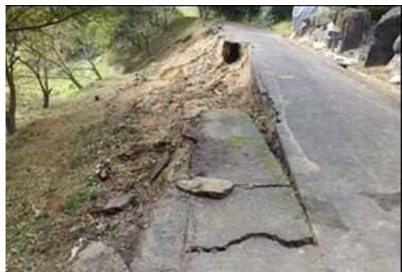
写真 台風による土砂崩れで崩壊した道路
