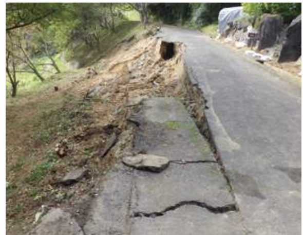
写真 台風による土砂崩れで崩壊した道路
