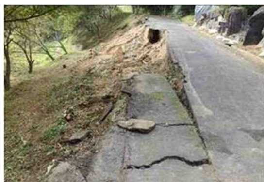
写真 台風による土砂崩れで崩壊した道路
