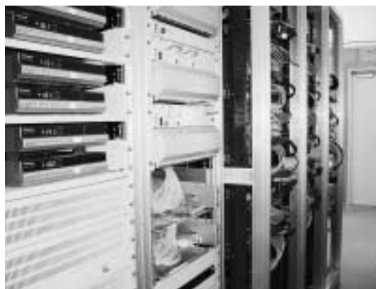
ケーブルテレビセンター設備
